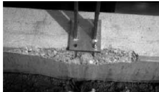
Distancia inadecuada al borde Figura 4.2.26
