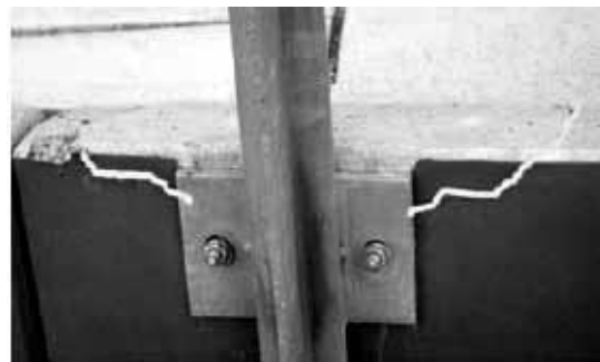
Falla por apriete de anclaje Figura 4.2.27
